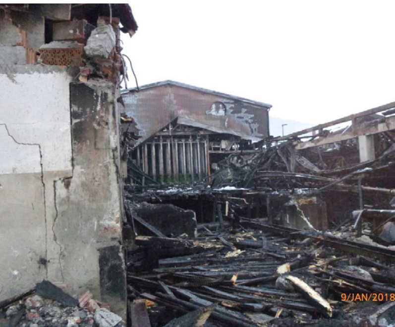
Sägelinie und Paketieranlage waren komplett ruiniert: Neben den zerstörten Maschinen kam es auch zu einem großen Unterbrechungsschaden
